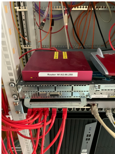
Abbildung 5: Der Switch ist dann mit dem hier zu sehenden Router verbunden. Der Router führt dann zur restlichen Infrastruktur des Hauses bzw. zum Internet.
